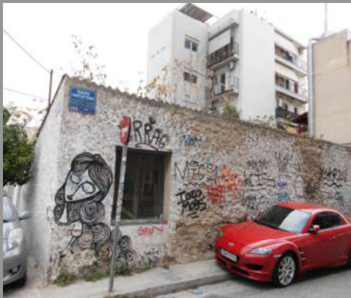
Κτίριο σε κακή κατάσταση
