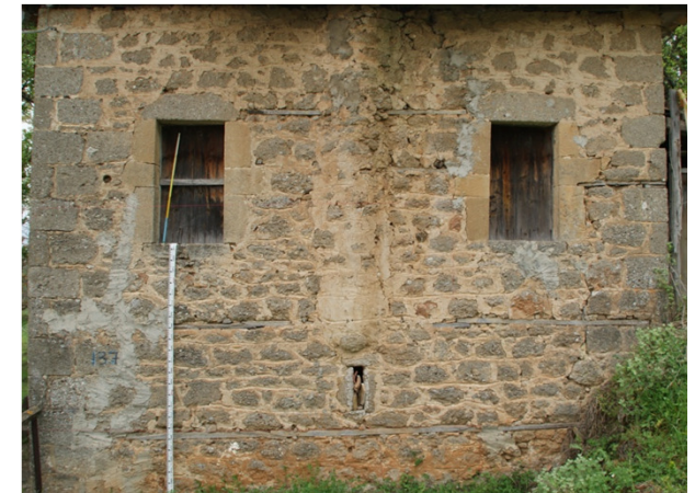
Ενδείξεις επισκευής ρωγμής μεταξύ των γωνιόλιθων αριστερά και του υπόλοιπου τοίχου
