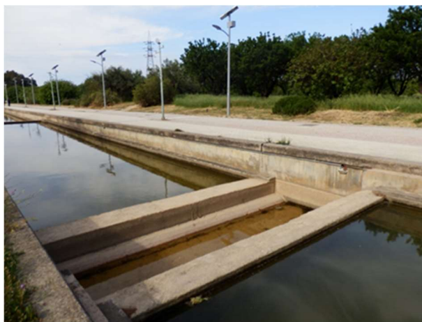
Εικόνα 68 : ποσότητα νερού στο κανάλι (22-04-17)
