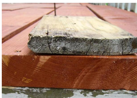
Εικόνα 3: Στρέβλωση και ραγάδες σε ξύλο εξαιτίας απότομων μεταβολών υγρασίας
